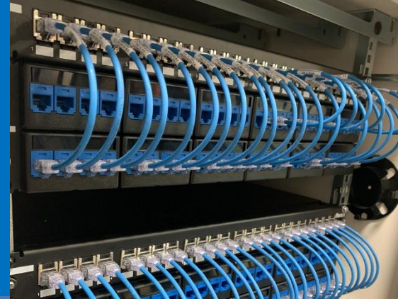
Telecomunicaciones y conectividad
